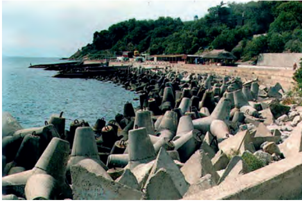
Рис. 6. Аварийные берегоукрепительные сооружения г. Алупки
